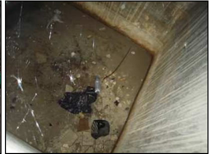
Réservoir d'eau à SAHDEC
